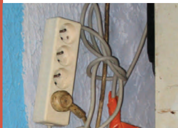
Installation électrique dangereuse
