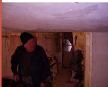
Hauteur sous plafond insuffisante
