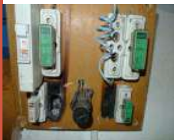
Branchements d'électricité vétustes
