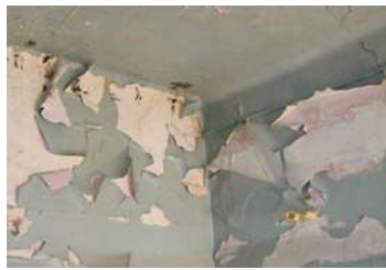
Peinture écaillée contenant du plomb
