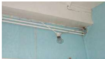
Eclairage insuffisant et dangereux
