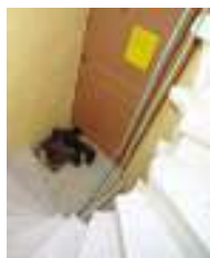
Absence de dispositifs de retenue des personnes
