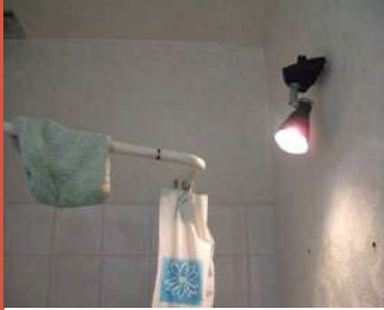
Branchement électrique dangereux
