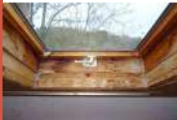
Absence de protection contre les infiltrations d'eau
