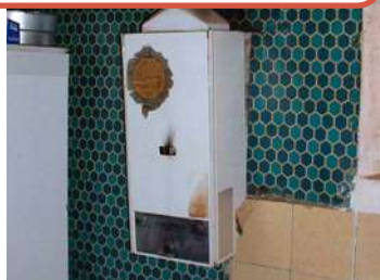
Absence de dispositif d'évacuation des gaz brûlés
